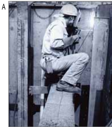
A 造船所内での溶接作業。過去には溶接ヒュームで火傷や火事にならないように火よけとして石綿クロスが敷かれることもありました。
