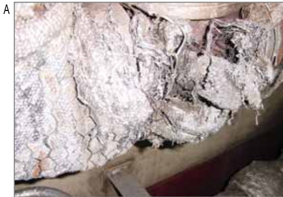
機関室の配管の石綿含有保温材です。写真のように劣化して毛羽立っている場合は、飛散の危険性があります。
