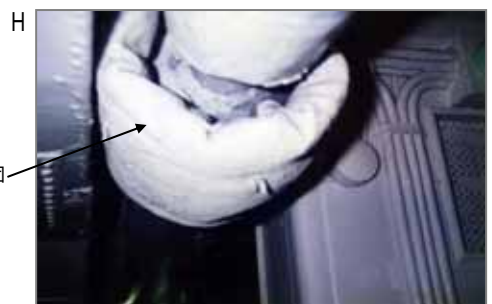
H 機関室フランジ部(配管のつなぎ部分)の石綿布団。布団は現場で型取り後に石綿布を裁断し内部に石綿原綿を封入しミシン裁縫や手縫い裁縫することもありました。石綿布団の制作者がばく露した可能性があります。
