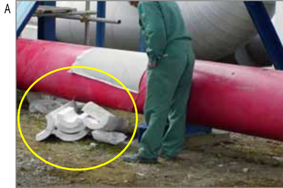
A 二つ割りのケイカル系石綿保温材。非常に軽く断熱性に優れていますが、もろくて飛散しやすいのが欠点。放置すれば自然劣化により飛散し、敷地を往来する労働者がばく露する可能性があります。
