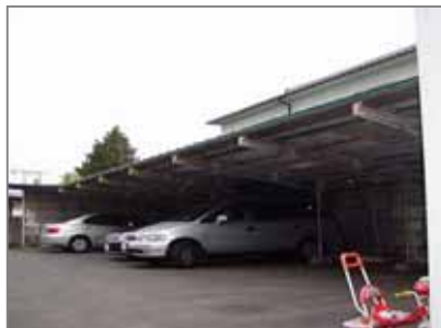
駐車場屋根裏(一方向開放型の駐車場。屋根裏に石綿フェルトが張られています。)
