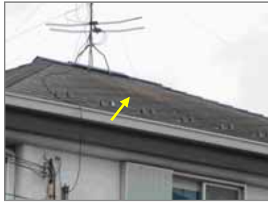
屋根材の塗料のはげ
