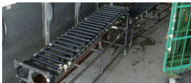
トラックの荷台に可動式のローラーコンベアを設置
